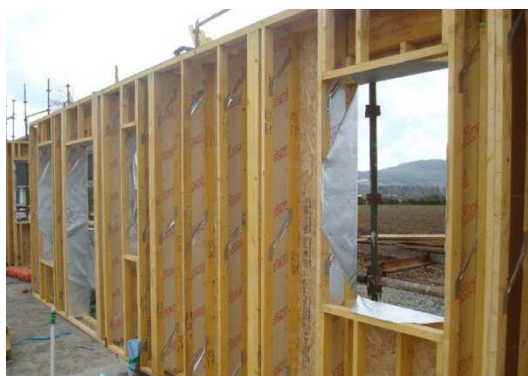
Obr. 44 Pohled na stěnu z POSI nosníků
