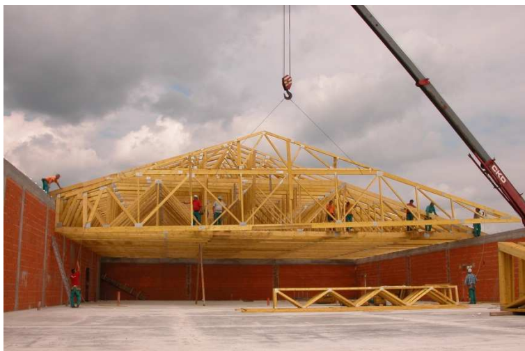
Obr. 36 Sedlové vazníky nad prodejní budovou
